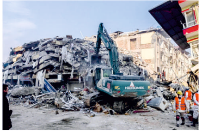
Antakya Gündüz Caddesi'nden Bina Enkazı
